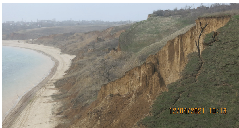
Фото 8. Обрушение коренного берега в границах садоводческого товарищества «Винзавод» г. Цимлянска Ростовской области
